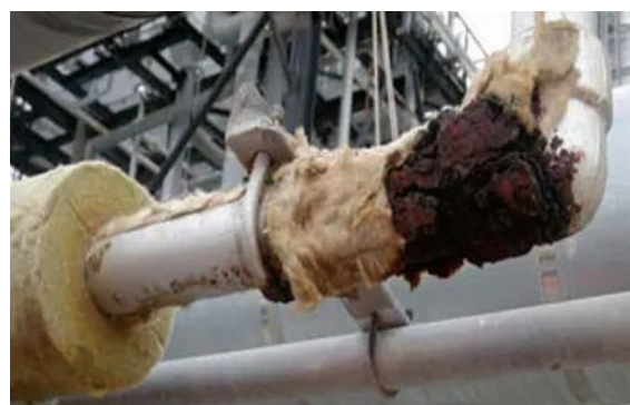
4. ábra. Megbontott szigetelőréteg alatti acélkorrózió
