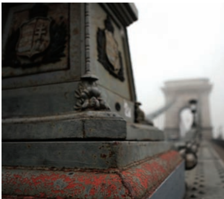
1. ábra. Festett öntöttvas és acélszerkezet korrodálódott felülete városi környezetben
