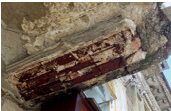
3. ábra. Acélbetét korróziós termékei által lefedített fedőréteg nélküli erkélykonzol
