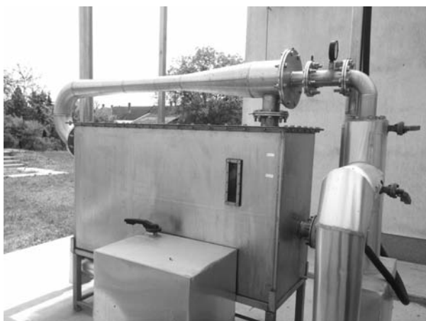
1. kép: Telepített VLV berendezés
