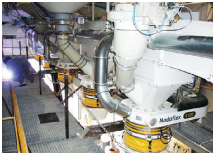
Példa a teleshókos Cimbría töltőcsőre. A tartályos autó betöltése zárt rendszerű töltési megoldással valósul meg
