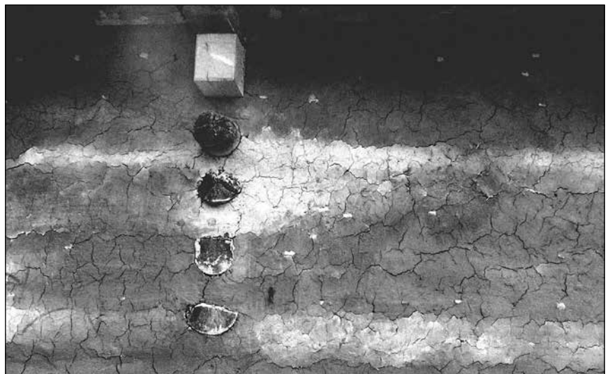
■ 7. kép: A tapasztott felület száradás utáni képe aggasztó, ennek is rá kellett jönni a technikájára ■ Photo 7. The image of the plastered surface after drying was alarming, we had to get the hang of its technique as well
