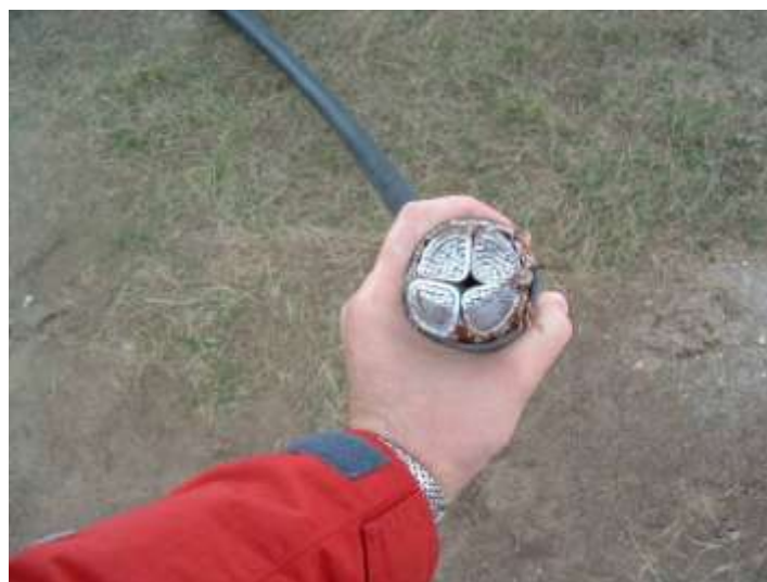
7. ábra. 4x240/50mm 2 vezetőkeresztmetszetű, 1100 m hosszú Al tápkábel
